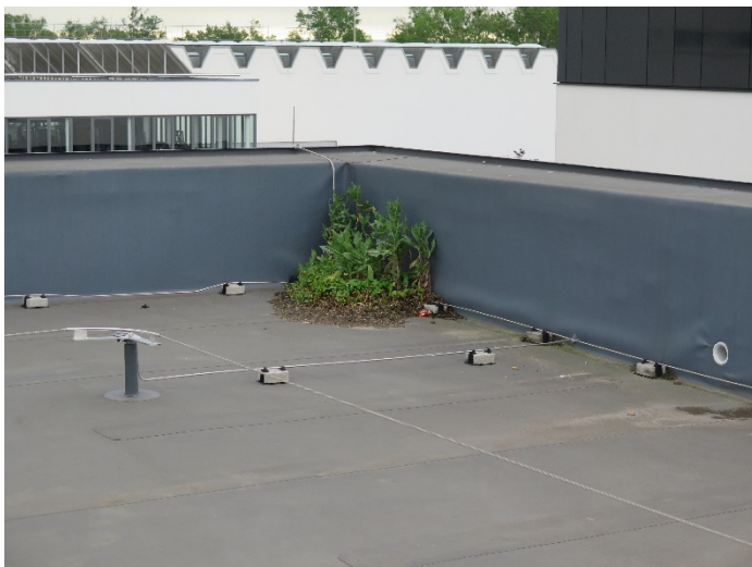
Bild 2: Ungewollter Bewuchs auf der Dachfläche kann die Dauerhaftigkeit des Daches negativ beeinflussen. (Copyright HFA)
