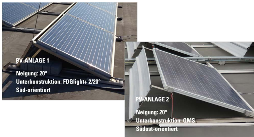
Bild 3: Für die Langzeituntersuchung der Holzforschung Austria wurden zwei PV-Module verwendet, die sich vor allem in der Belüftung der Module voneinander unterscheiden. (Copyright HFA)
